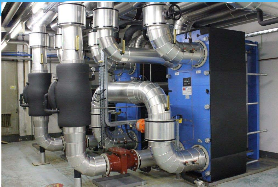
BIT : Echangeurs rafraîchissement, 2 x 3MW Echangeurs condenseur, 6 MW
