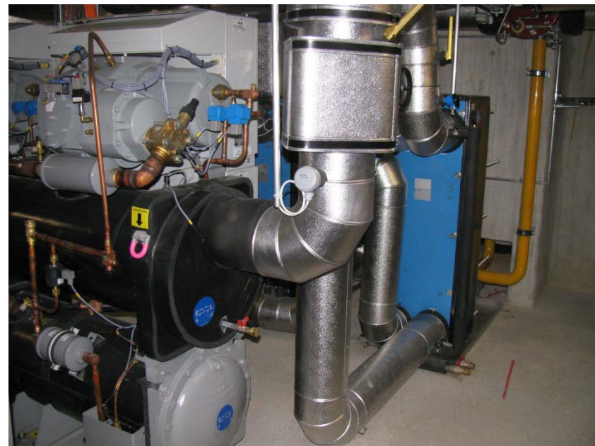
Foyer Sécheron : 2 pompes à chaleur Puissance 250 kW et 350 kW
