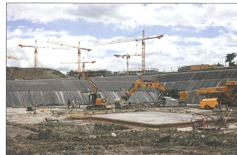
L'éco-quartier est précurseur suisse en matière de labellisation Minergie-A®, voire même, pour une partie des immeubles, d'une combinaison MINERGIE-A-P-ECO®. © JORG BROCKMANN
