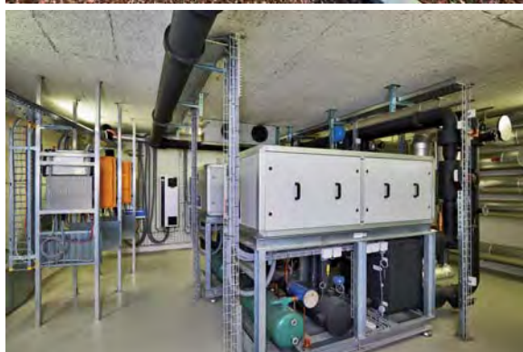
... die Wärmepumpen. Eine überzeugende Gesamtlösung.
